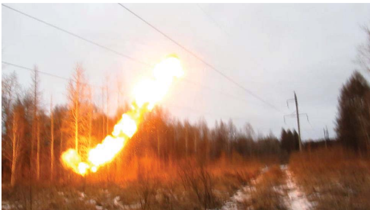
Рис. 5.17. КЗ ф. «А» на землю в пролетах опор №2 - №3 отпайки на ПС Хвойная (Продолжение)
