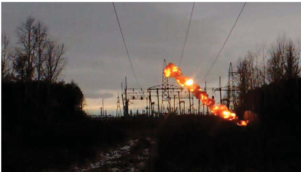
Рис. 5.18. КЗ ф. «А» на землю в пролетах опор №2 - №3 отпайки на ПС Хвойная (Продолжение)
